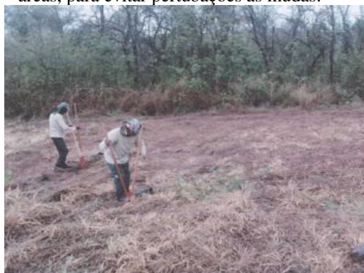
Figura 05: Realização da abertura dos berços para a realização do plantio das mudas.
